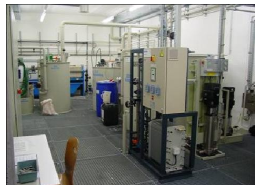
Traitement de l'eau d'entrée et des effluents
